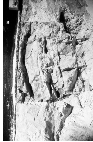
fig. 4 : Coupe du mur sud du chevet (embrasure de la porte de la sacristie actuelle) : blocs de parement et fourrure (cl. A. HARTMANN-VIRNICH, 1998).
