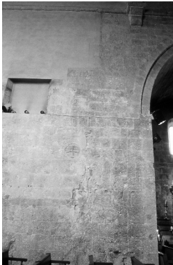
fig. 8 : Angle du bras nord et de la nef : ruptures d'assise à la reprise de l'attente construite avec la partie orientale de l'édifice (cl. A. HARTMANN-VIRNICH, 1998).
