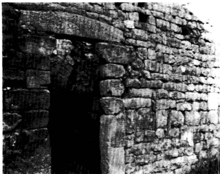
Fig. 2 : Mur est-ouest séparant le croisillon sud de la croisée. De gauche à droite : porte f et « jours » y et z.
