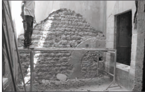
Fig. 1 : Dégagement de l'élévation d'une tour romane lors d'un ravalement de façade, place du Change à Avignon (Cliché F. Guyonnet, Service d'Archéologie du Département de Vaucluse, 2006)
